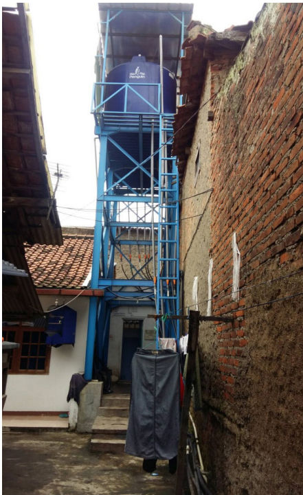
Gambar 4.8 Reservoir Sistem di Desa Margahayu Tengah
